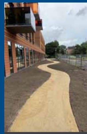
Aanleg van het tussenpad. Het pad wordt half verhard met aan weerszijden gras en bloemen.
